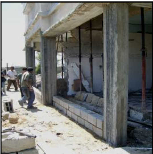
صورة توضح بعض الأعمدة بعد الترميم
